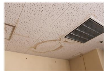
<雨漏りの跡が残る天井>
