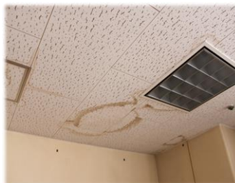
＜雨漏りの跡が残る天井＞
