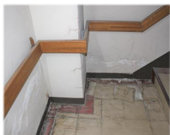
＜タイルのはがれた床面＞
